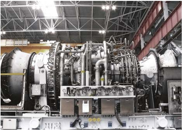
ГТУ 32 МВт на производственной площадке «Невский Завод»
