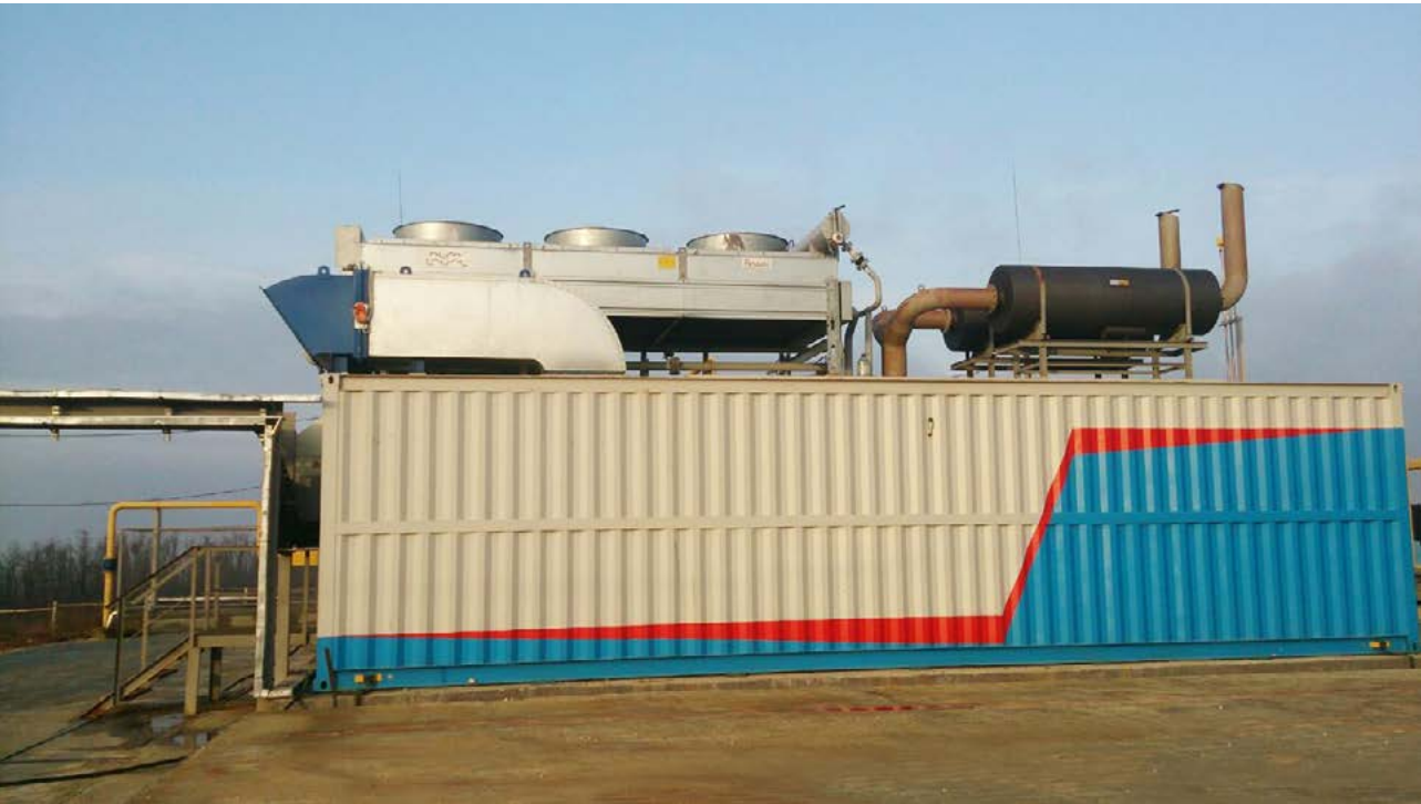
ГПЭС на КС «Казачья»
